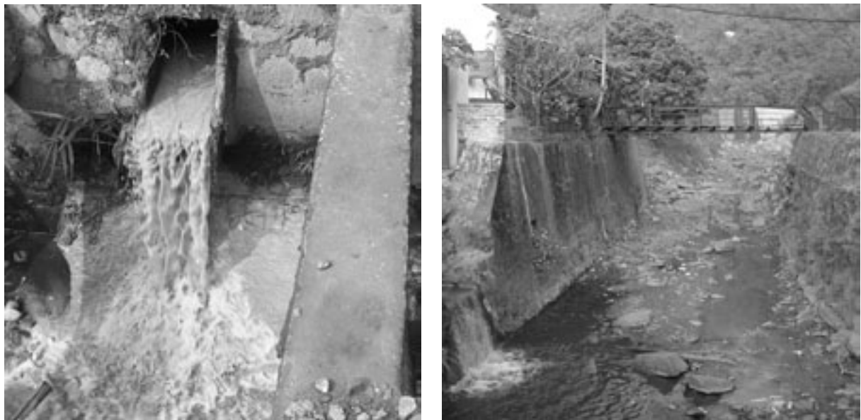
Abb. 2: Ableitung von trübem Grubenwasser des Stollens +122 tay in ein Gerinne (links) und die Einleitung des Stollens +122 dong in den Vorfluter (rechts; SCHLENSTEDT & DENKE, 2009)
