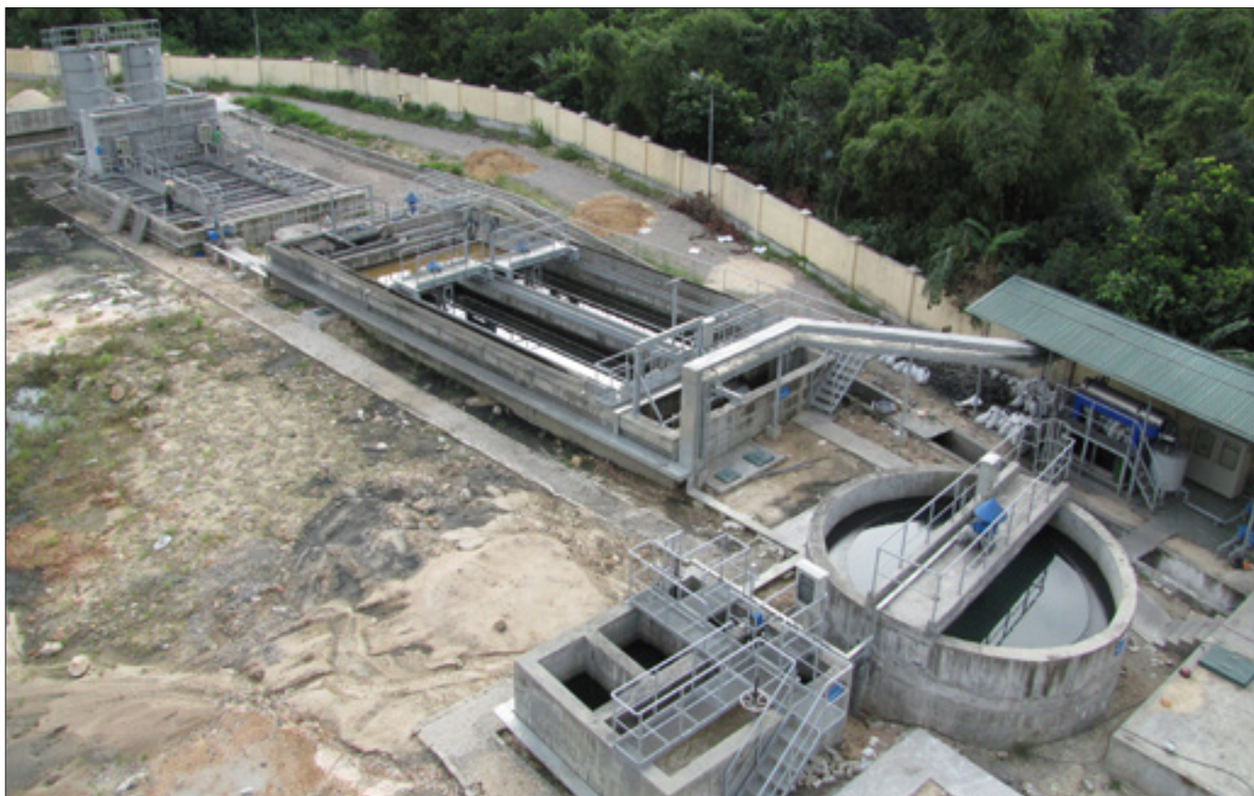
Grubenwasserreinigungsanlage in Vang Danh, Vietnam
