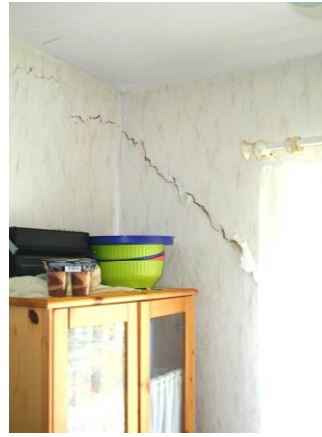
Bild 2 Risschäden im Gebäude
