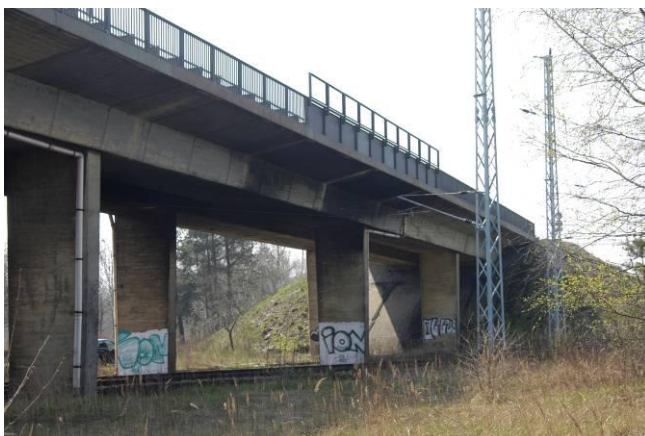
Bild 2: Bauwerk vor Instandsetzung
