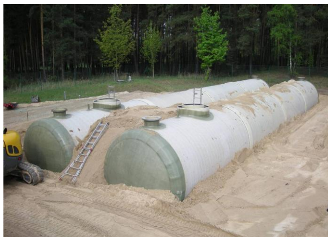
Bild 3 Zusätzliche Rohrspeicher aus GFK mit je 160 m 3 Fassungsvermögen
