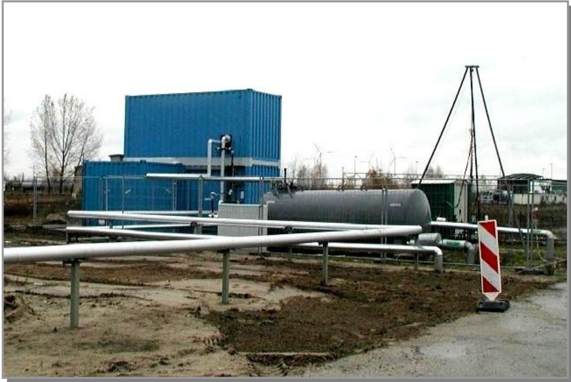
Bild 1: Haltungsbrunnen HB 21n in Schwarze – Pumpe
