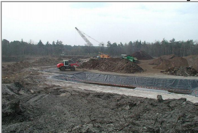
Bild 5: Zwischenlagerfläche mit Sickerwasserbecken
