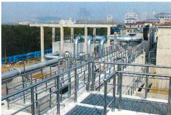
Biofiltrationsanlage einer chinesischen kommunalen Kläranlage
